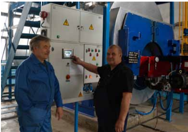
Механик С.И. Гачкайло (слева) и сменный механик котельной цеха зачистки С. Н. Шабалин.
