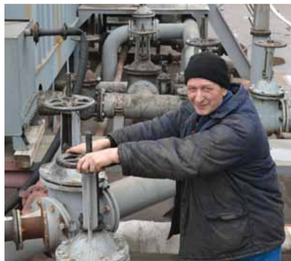
Помощник механика НЗС А.Ф. Ведерников поворачивает вентиль подачи пара.
